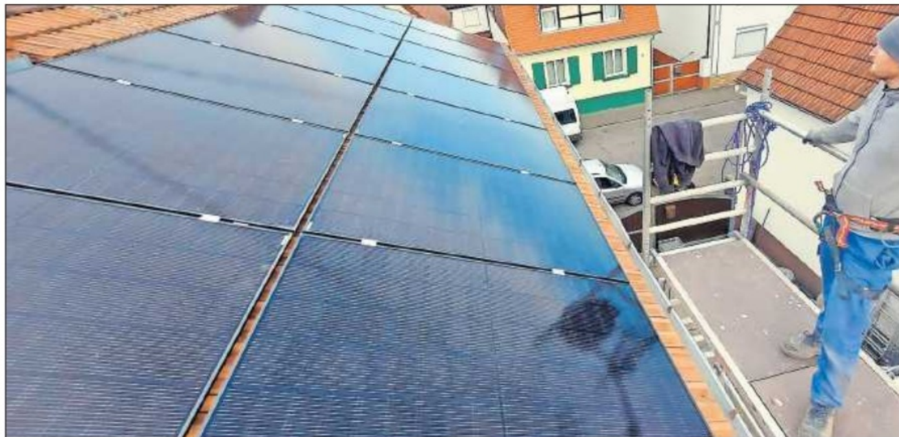
Selbstbau-Photovoltaik: eines der Projekte der Energiegenossenschaft.
