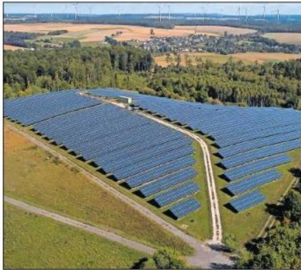
Photovoltaik: Freiflächenanlage – hier im Hunsrück.
